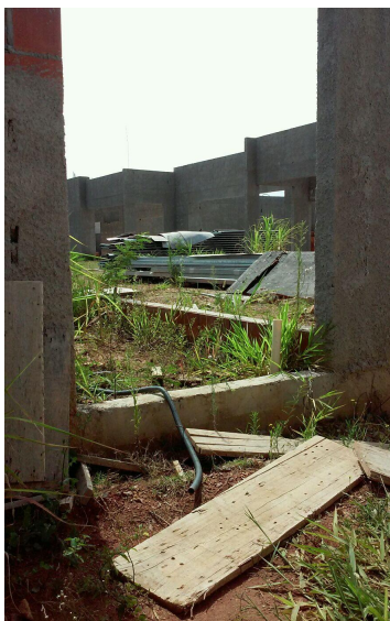
estruturas metálicas deixadas na obra
